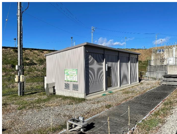
伊達方発電所（掛川幹線水路）
