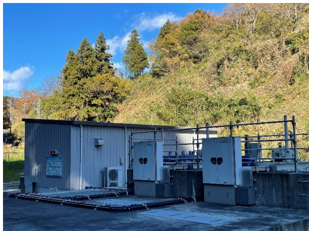
西方発電所（掛川幹線水路）
